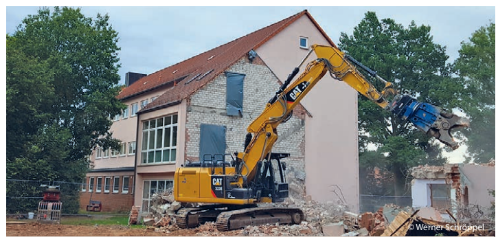
Der westseitige Flügel der Röthenbach Grundschule wurde bereits im Herbst 2018 abgerissen, um Platz für den Hortneubau zu schaffen.
