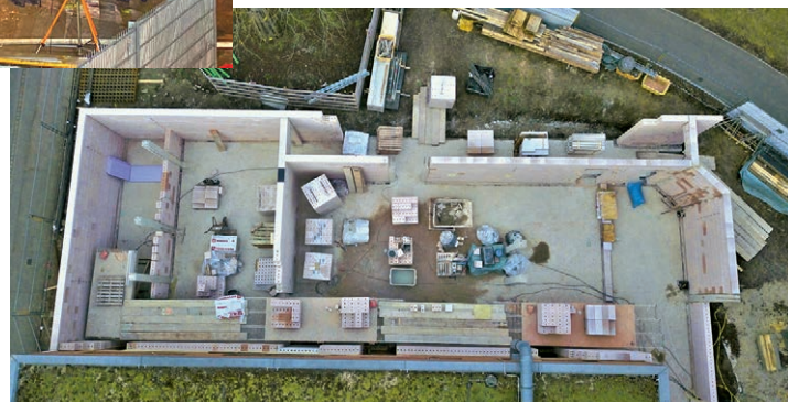
Der Anbau mit Sanitär- und Sozialräumen nimmt Gestalt an – bald wird er mit dem Dach geschlossen.
