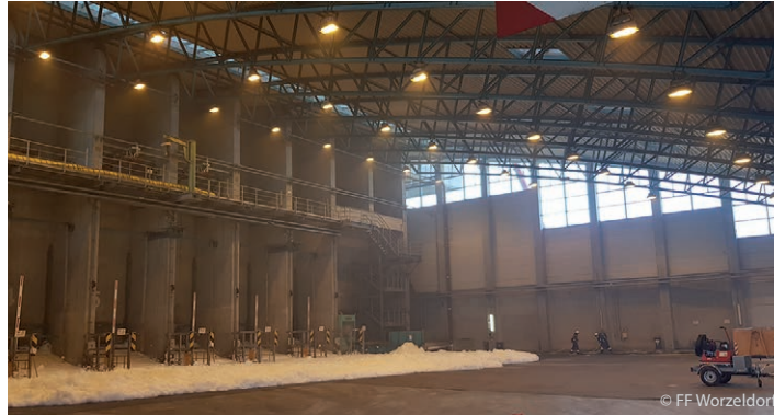
Der Müllbunker ist mit Schaum geflutet, der nun in die Anlieferung zurückläuft.
