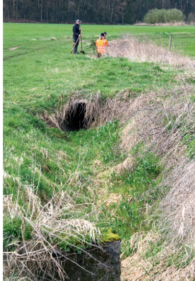
Im vergangenen Jahr hat der Bewuchs die Gräben zuwachsen lassen, der den Wasserfluss behindern würde.
